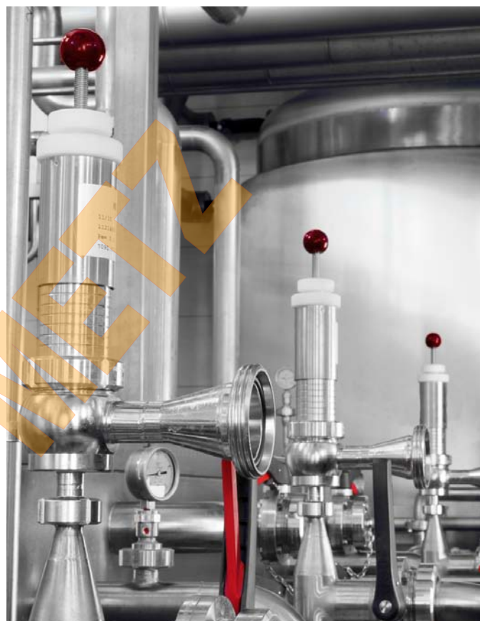
Vanne à bonde sur une installation HTST pour la bière
